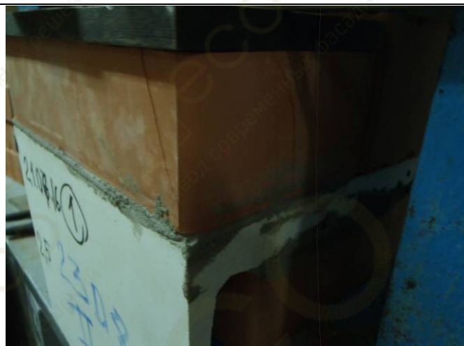
Фото 26. Осмотр дефектов после разрушения образца. Видна наклонная трещина в стенке испытываемого уголка и наклонные трещины шириной раскрытия 1,5-2 мм на всю высоту кирпича (в составе образца)
