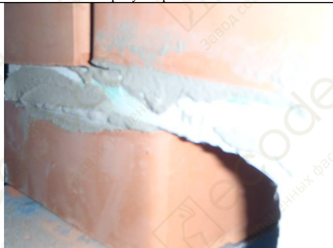
Фото 48. Образец уголка декоративных накладок из стеклофибробетона УГ 4-7 после испытания. Видна наклонная трещина в полке уголка в сторону опорной зоны.
