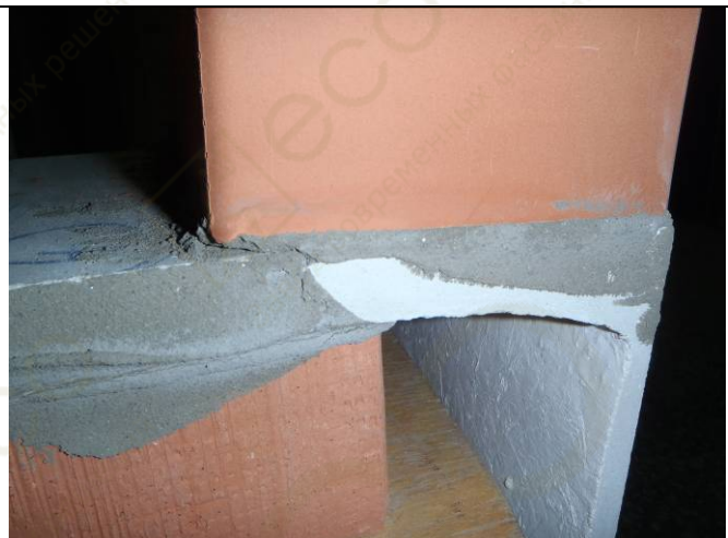
Фото 20. Образец уголка декоративных накладок из стеклофибробетона УГ 1-4 после испытания.
