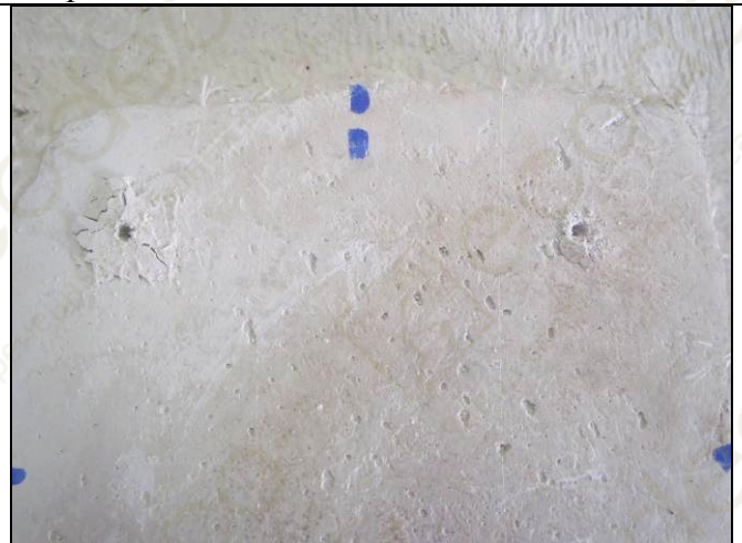
Фото 6. Испытание крепежного подвеса потолочной панели из фиброгипса. Испытание №1. Крепление на 4 шурупах. Вид образца после испытаний. Вырыв шурупов.
