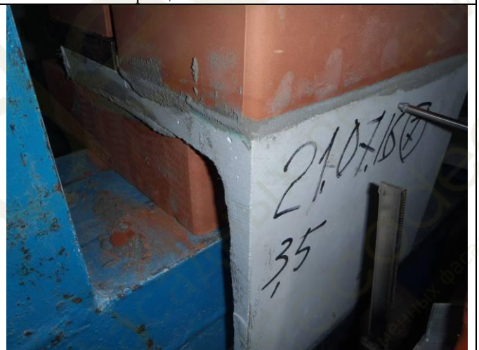
Фото 40. То же, другой ракурс. Видна наклонная трещина в полке уголка.
